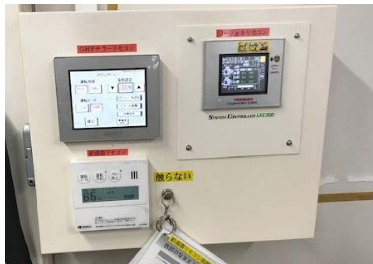
各操作盤（事務室）
