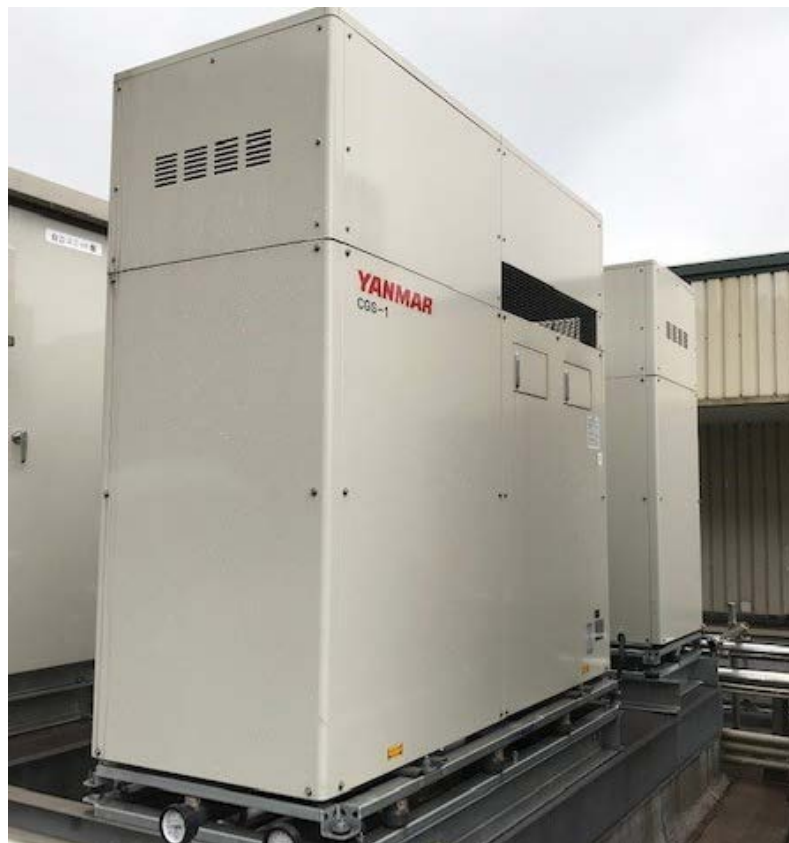
ガスエンジンコージェネ（25kW 3基）
