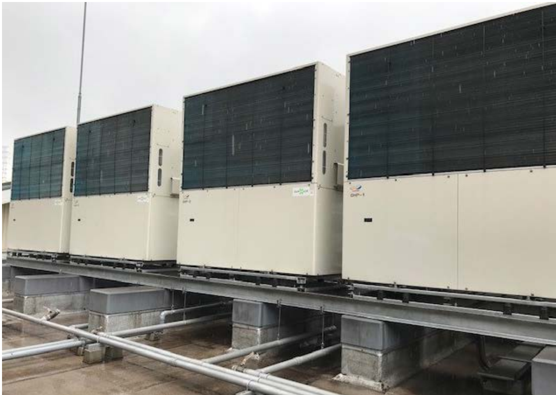
GHPチラー（25HP 8基）
