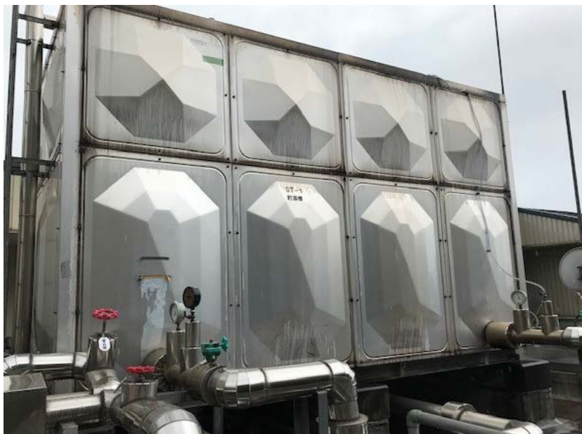
20トン貯湯タンク
